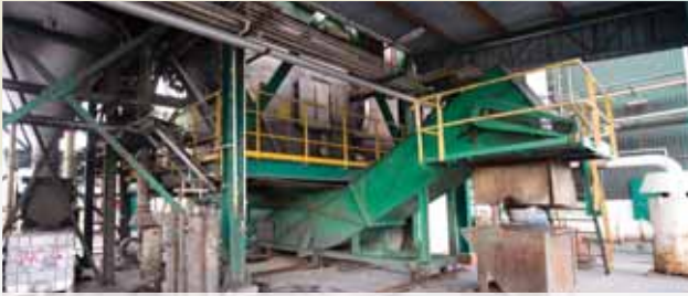
INC4 slag conveyor
